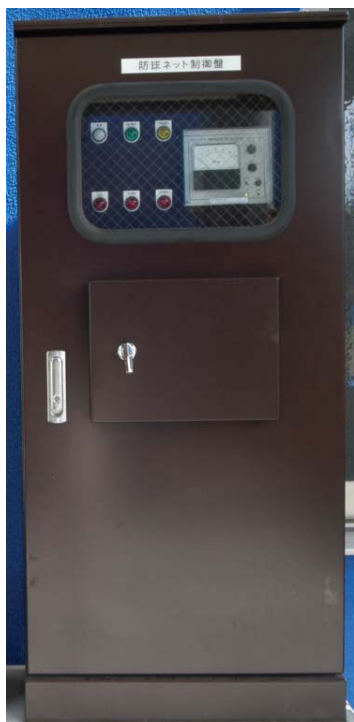
写真-5 昇降システム制御盤
