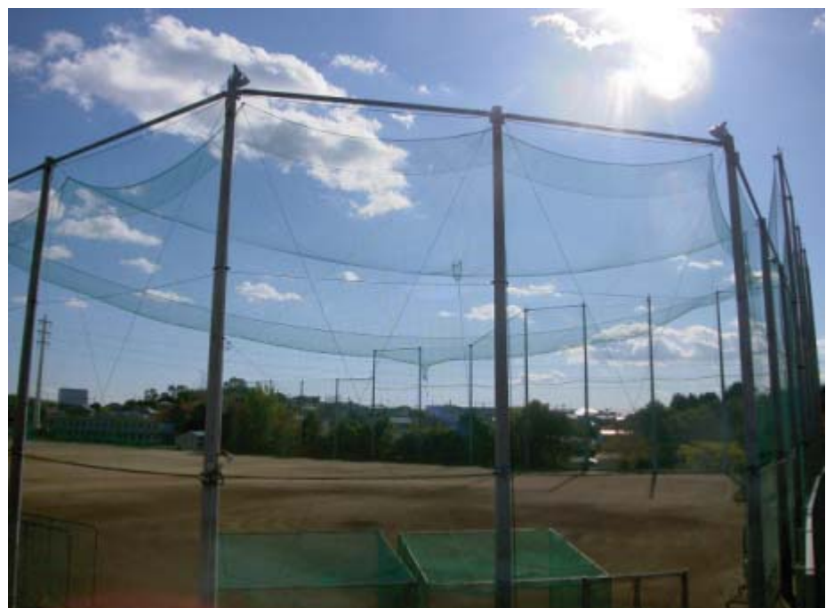
写真-4 天井ネット付防球ネット
